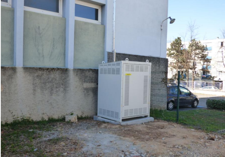
Local onduleur (shelter) St Priest école Jules Ferry (71 kWc)
