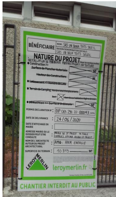
Panneau de chantier pour St Priest école Jules Ferry (71 kWc)
