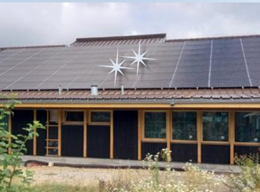
Les panneaux photovoltaïques VOLTEC sont installés sur le toit de l'école de St Alban de Montbel, premier toit pour Avant-Pays Solaire
